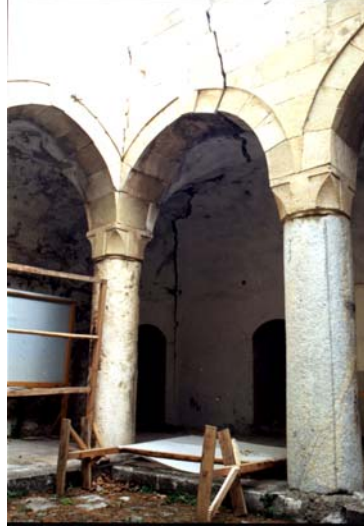
Fotoğraf 24. Revaklarda Meydana Gelen Çatlamalar
