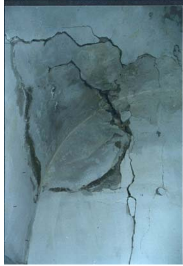
Fotoğraf 25. Yapıdaki Oynamadan Dolayı Hücreselerde Oluşan Çatlaklar
